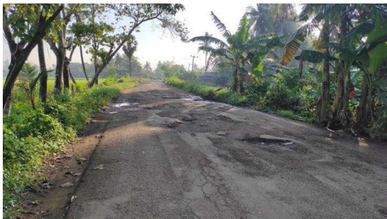
Gambar 1. Kondisi Jalan di Desa Turu Cinnac
