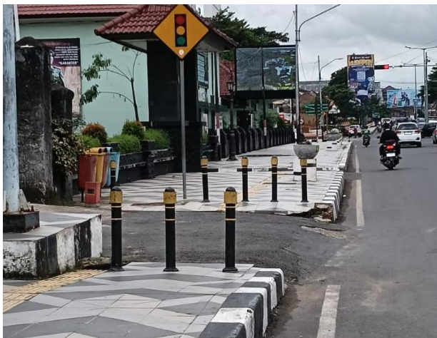
Gambar 8. Kondisi Jalur Pedestrian
