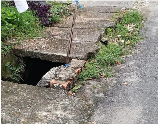
Gambar 3. Kerusakan Jalur Pedestrian
